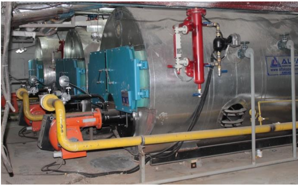
Resim 43: Doğalgaz ile Çalışan Yeni Kalfifer Kazanları
